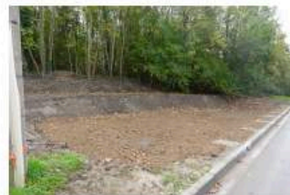
Nouveau bassin de rétention des eaux pluviales de la chaussée
