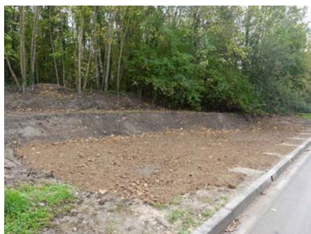
Bassin de récupération d'eau
